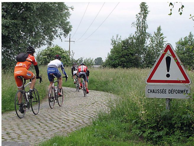
1) Chaussée très déformée mais pavés secs en 2012.
