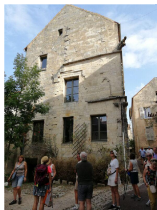
36 I-a du boulot. Façade fissurée d'une maison
